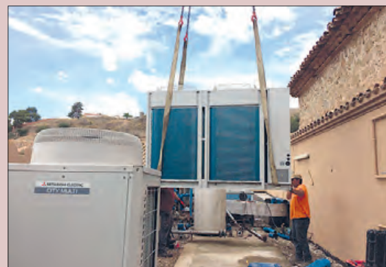
Nou aparell de climatització
