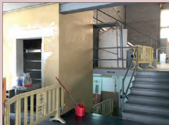
Plataforma elevadora al Poliesportiu
