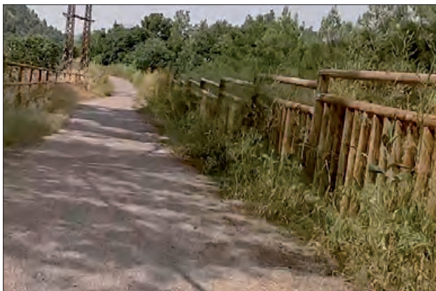
Una imatge de l'estat de la Via
